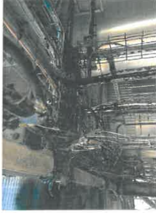
Chemins de câbles calcinés suite à un incendie d'origine électrique
